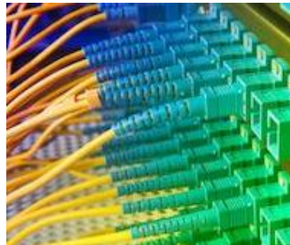
Het overgrote deel van de huidige communicatie verloopt via glasvezelverbindingen
